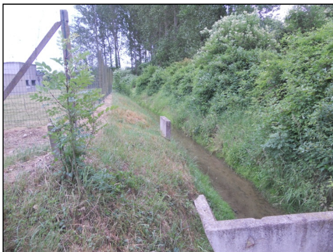
Exutoires des eaux traitées de la station de Caix dans l'OTEE
